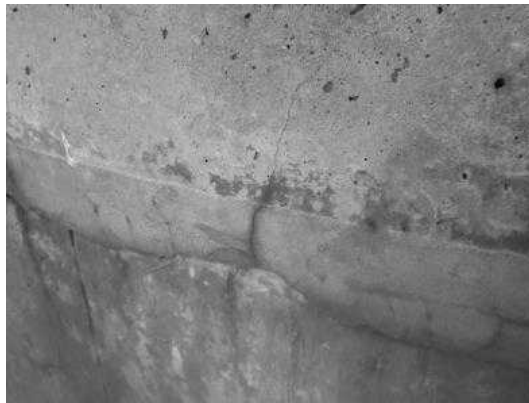
(ก) ครอบเสาเข็มมีรอยแตกขนาดเล็กบริเวณกว้าง
