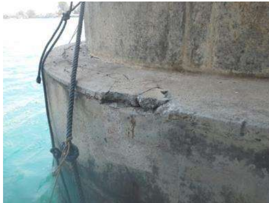
(ง) ครอบเสาเข็มหลุดล่อนบริเวณกว้าง
