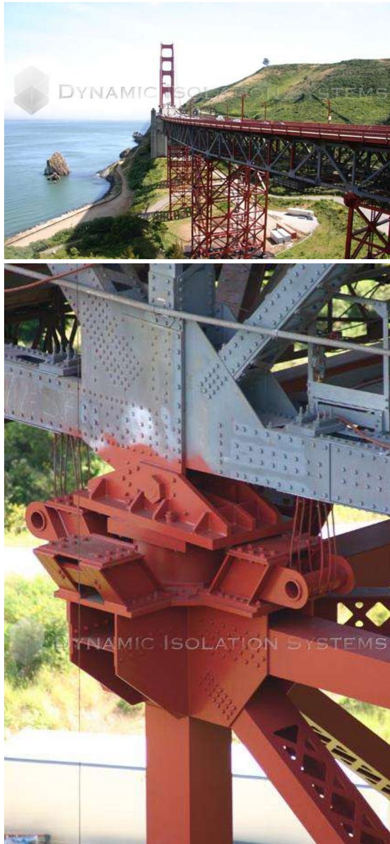
รูปที่ 6.10-16 ตัวอย่างสะพาน Golden Gate ที่ติดตั้ง Dynamic Isolation System (ที่มา: http://www.dis-inc.com/applications.html#bridge_retrofits )
