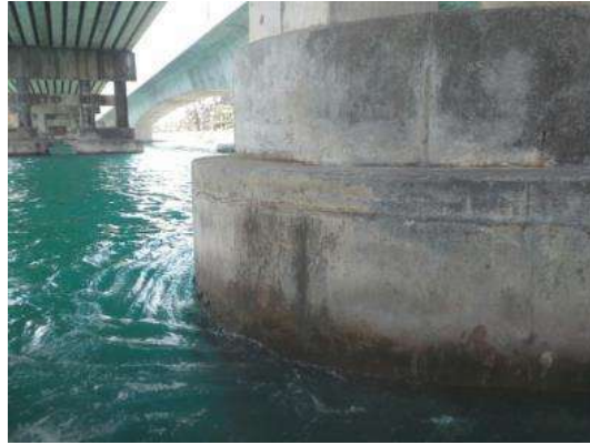
(ง) ครอบเสาเข็มมีรอยแตกขนาดเล็กบริเวณกว้าง
